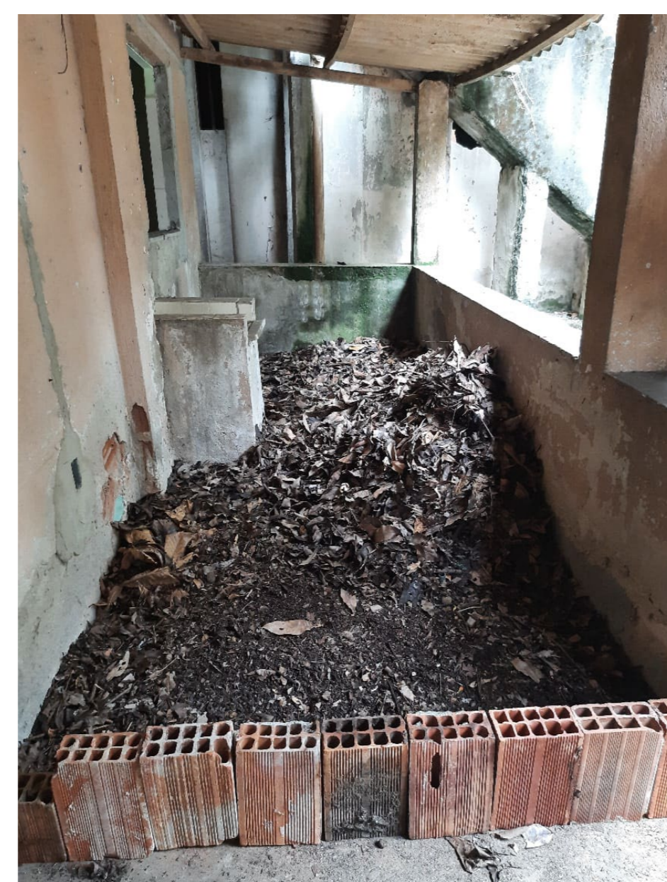
Composteira externa com cobertura
